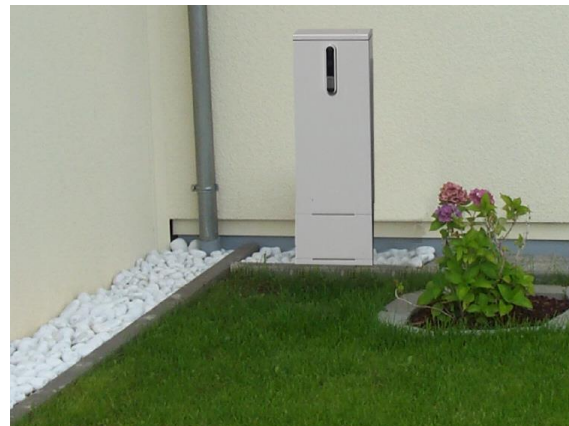
Bild 2: Beispiel einer Anschluss säule
